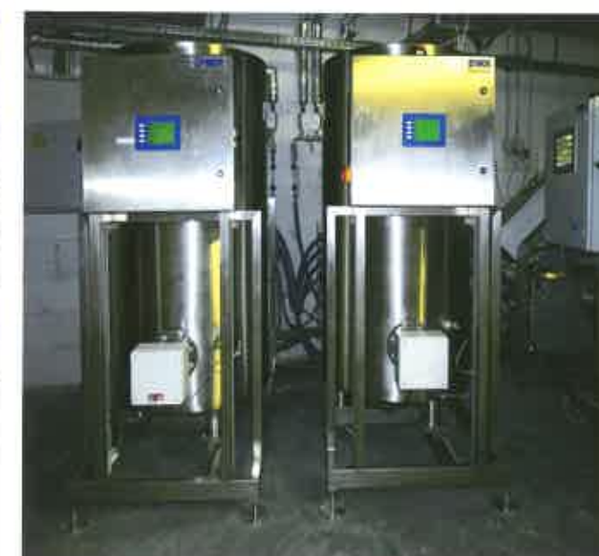
Na de voorbehandeling treden twee aparte reversed osmosesystemen (RO) in werking met twee aparte hittedesinfectiesystemen en twee aparte CEDI-systemen.
